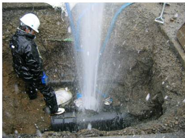
鑄鉄管 口径 450mm（昭和 36 年布設） 平成 19 年度破裂
