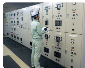
電気設備点検
