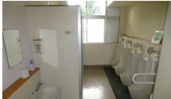
位置: 南校舎 男子トイレ 撮影日: 平成30年8月6日
