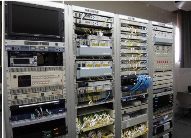
信州新町支所 3階 ヘッドエンド設備
