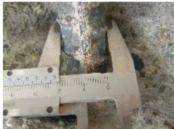
【鉄筋の腐食度】
