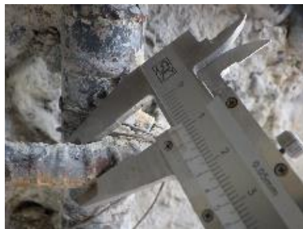
【鉄筋の腐食度】
