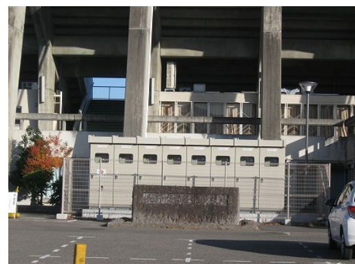
屋外設置受変電設備（キュービクル）
