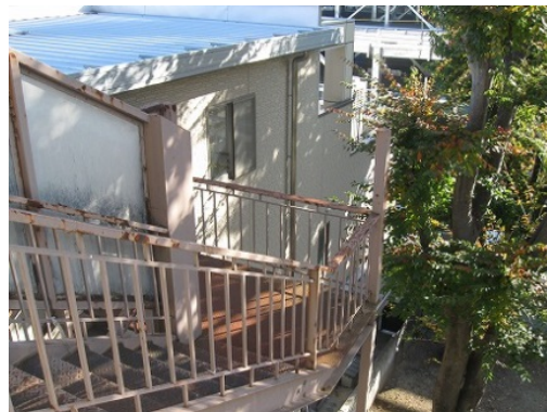
鉄骨階段の錆
