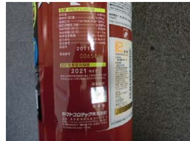
消火器使用期限
