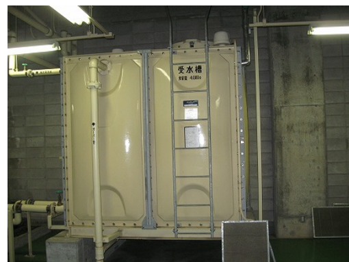
FRP 製受水槽 (屋内)
