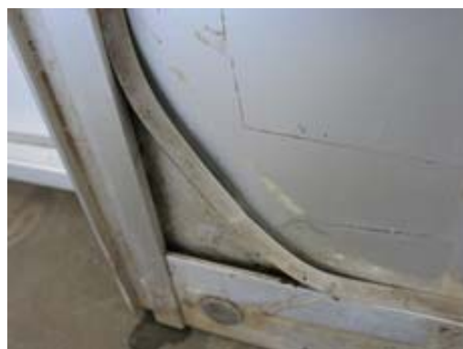
成型ゴム劣化
