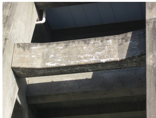
コンクリートのひび割れ
