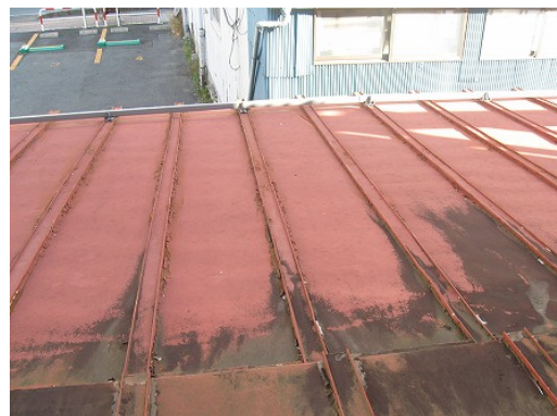
鉄板葺きの錆
