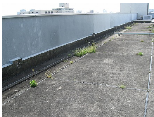
目地の劣化と雑草
