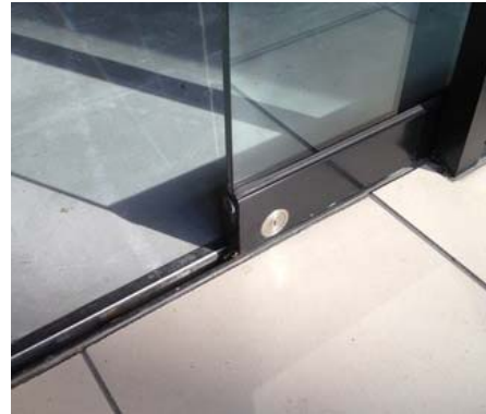
自動ドアレール
