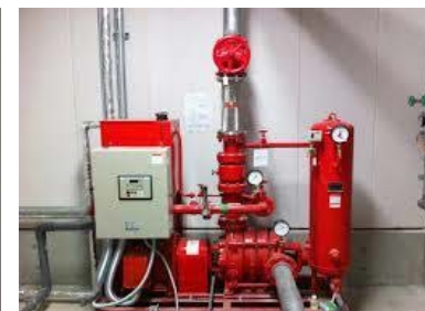
スプリンクラーポンプ
