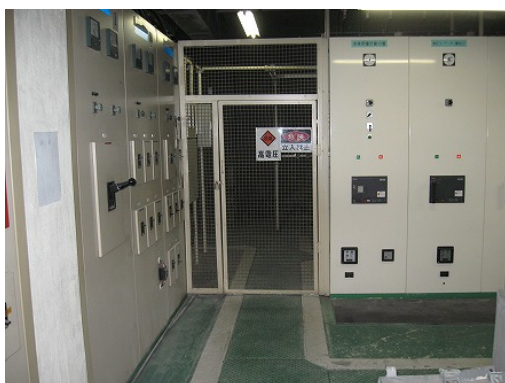
開放型変電所
