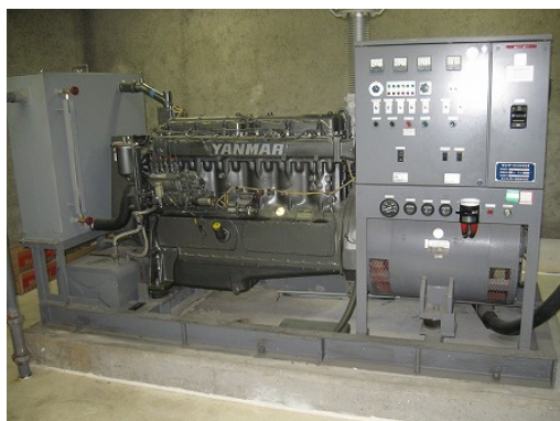
非常用発電機（屋内）
