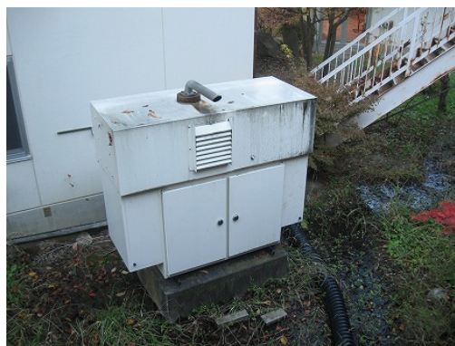
非常用発電機（屋外）
