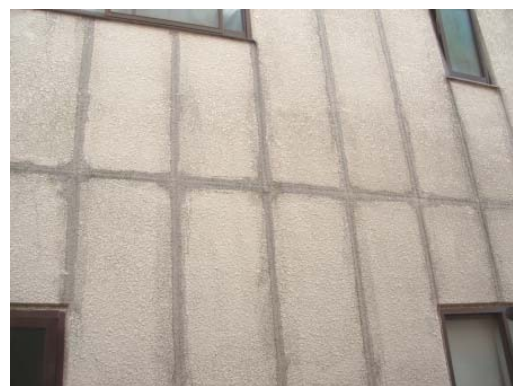
シーリングによる汚れ
