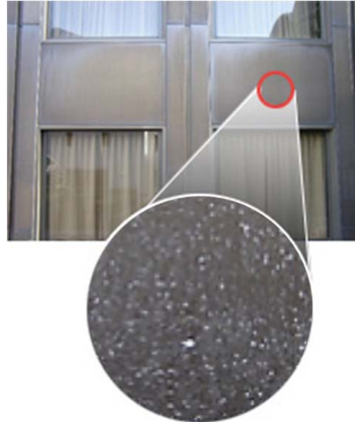
アルミパネル 点食(白い点状の腐食)
