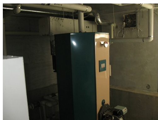
給湯ボイラー
