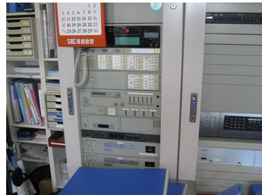
非常放送設備
