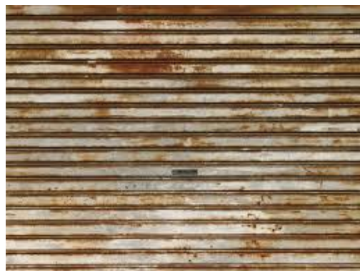
シャッターの錆
