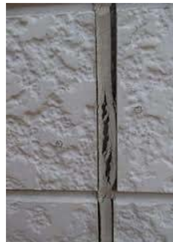
剥離、破断、ひび割れ
