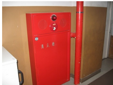
屋内消火栓箱
