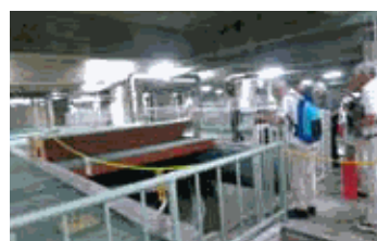
宮渚浄化センター：地下の反応層
