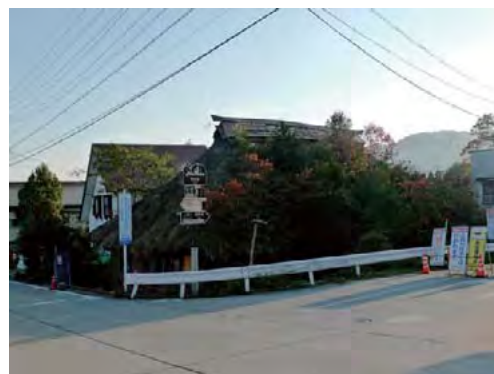
空き家となって急速に老朽化が進む民家
