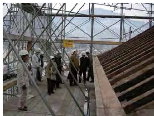
地方文化財保護審議会による建造物保存修理の現地指導
