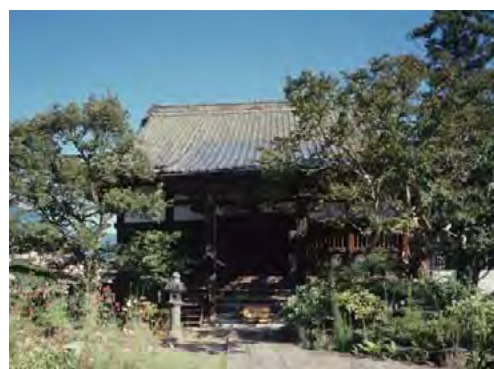
劣化の進む大英寺本堂（長野県宝）
