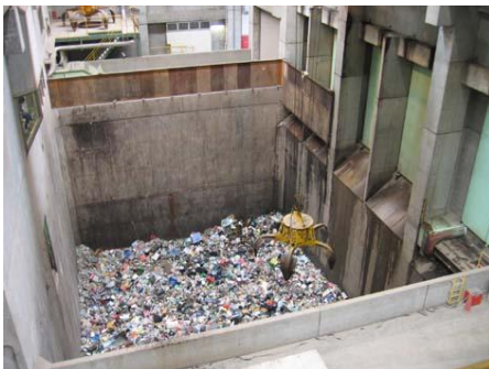
資源再生センター不燃ごみピット
