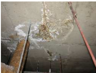
躯体の劣化に伴う雨漏り
