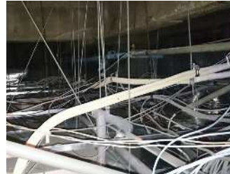
電気設備の老朽化・残置
