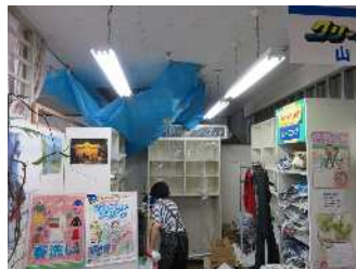
給排水管からの漏水
