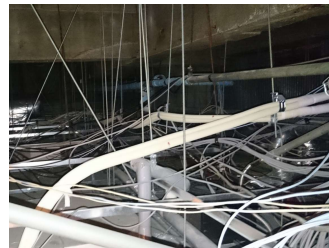
電気設備の老朽化・残置
