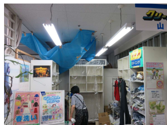
給排水管からの漏水
