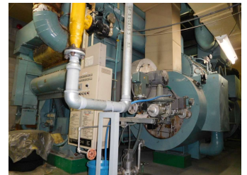
撤去困難な機械設備
