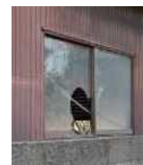
窓が割れた 管理不全空家
