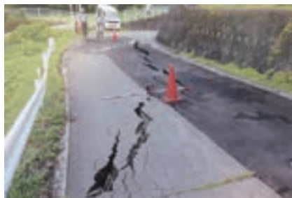
【道路に亀裂が！（2020年7月）】
