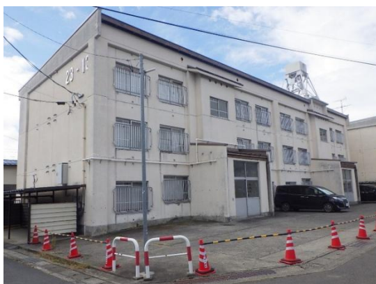
写真：返目団地大規模修繕前
