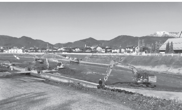
3月の管内視察で説明を受けた北八幡調整池の 改修工事現場
