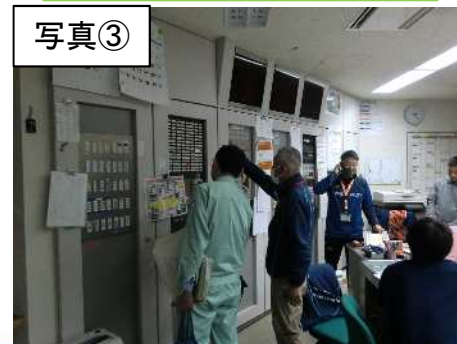
自動制御設備 更新
