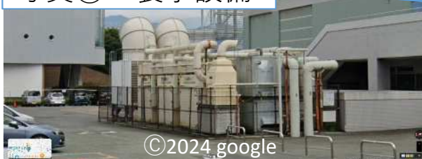
写真① 製氷設備
