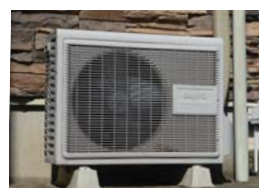
空気熱源ヒートポンプ
