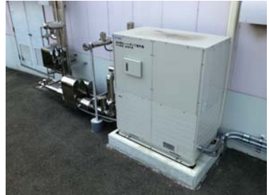
地中熱ヒートポンプ（室外機）
