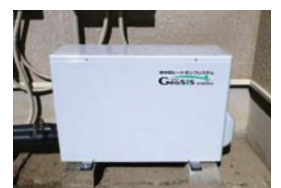
地中熱ヒートポンプ
