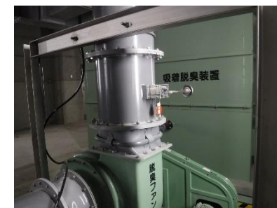
省エネルギーの脱臭設備
