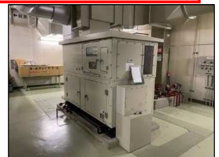
自家発電設備
