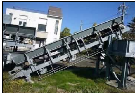
フライトコンベヤ (松代1号雨水ポンプ場)
