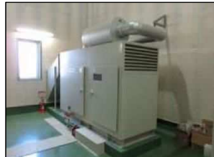
自家発電装置 (砂田雨水ポンプ場)
