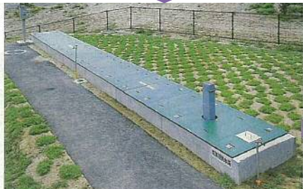
塩素接触水路
