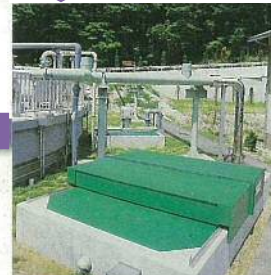
汚水流入管と汚泥ポンプ室
