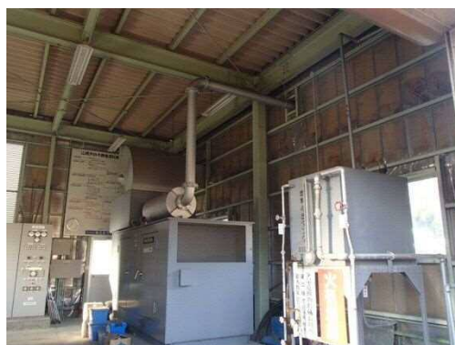
山根井ポンプ場（建物内部）
