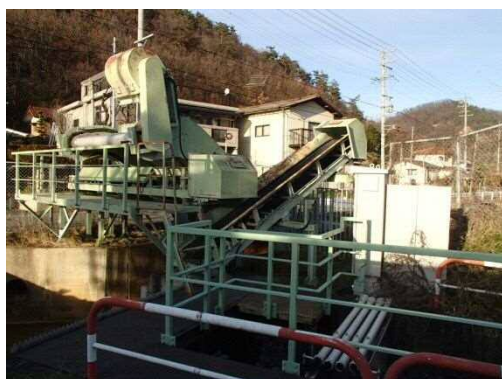
山根井ポンプ場（除塵機）
