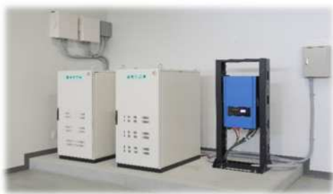
蓄電設備 (イメージ)
