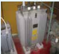
変圧器 （平成5年以前製造）
