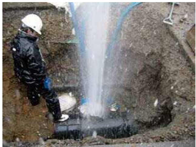
送水管φ450mm 破裂状況
