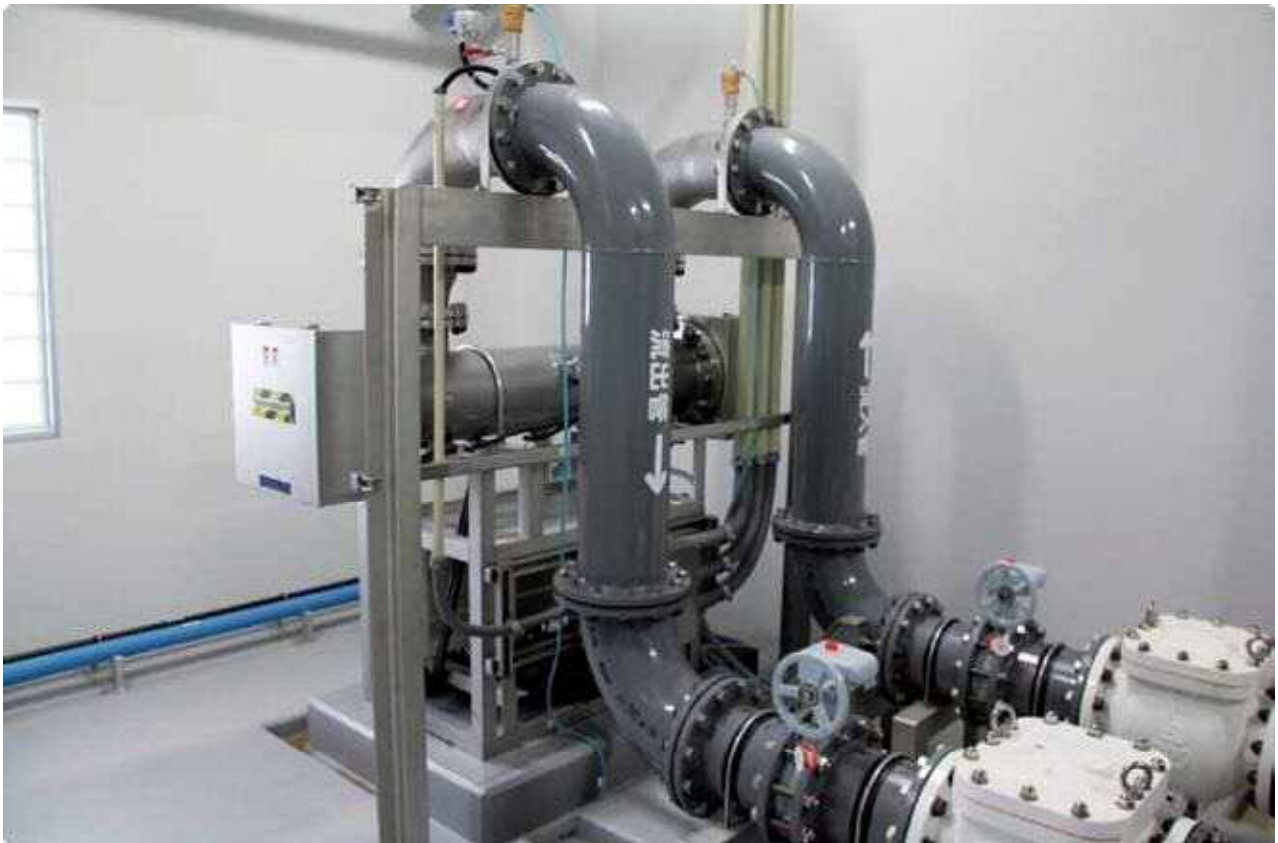
西沖水源（豊野）の紫外線処理設備 平成24年竣工
