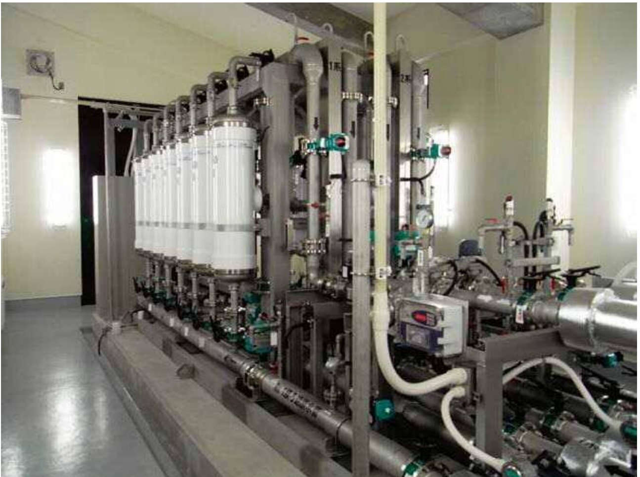
戸隠浄水場（戸隠簡易水道） 膜ろ過施設 平成25年竣工 浄水量920m 3
