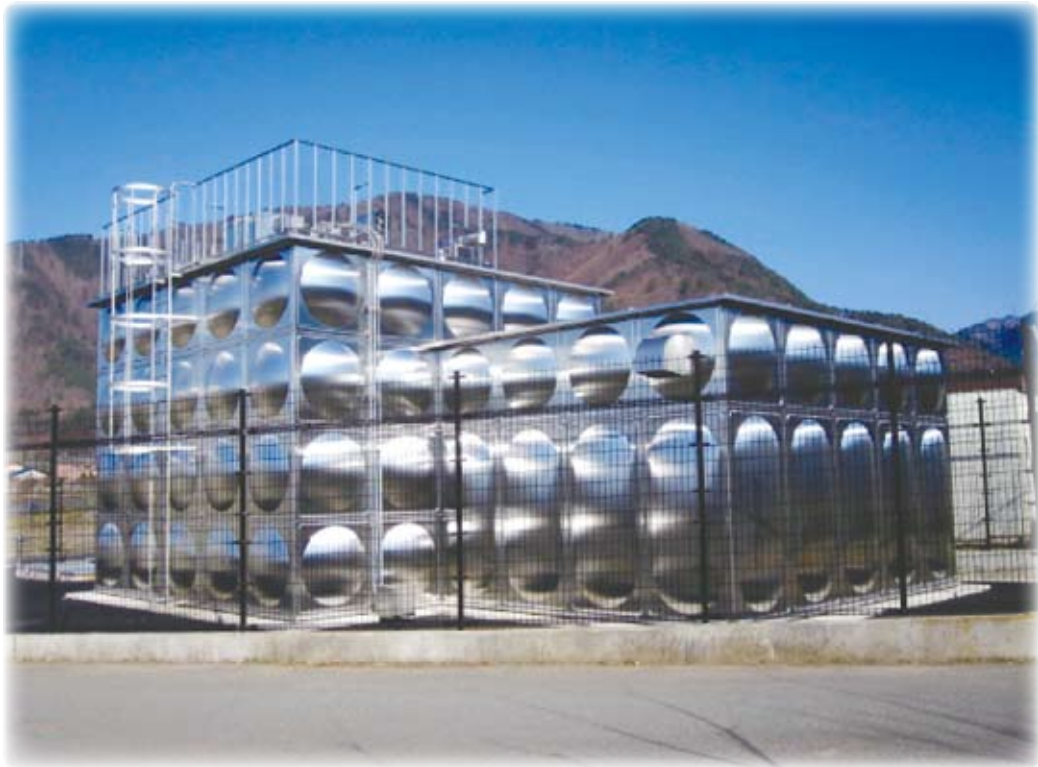
塚本水源（若穂）ポンプ井 平成25年竣工
