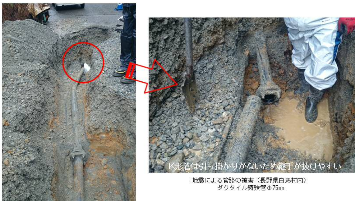
図 8 長野県神城断層地震による長野県白馬村での管路被害（平成 26 年 11 月 22 日）
