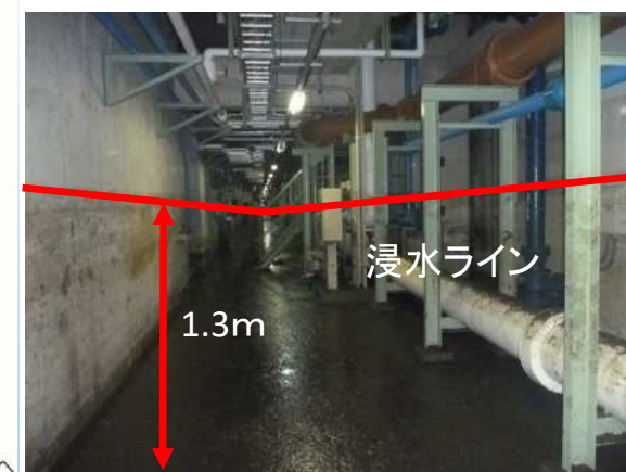
水処理棟地下浸水状況
