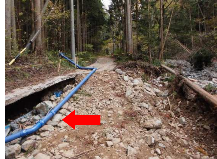
仮設配管(保科水源～山内浄水場)
