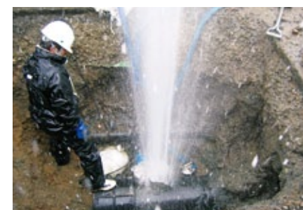
(老朽管の破裂 布設後46年経過)
