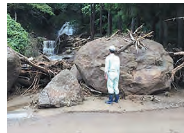
平成29年8月 鬼無里地区 集中豪雨による土砂災害で道路沿いに 布設された水道管が破損しました
