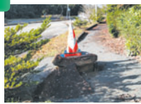
飛び出したマンホール
