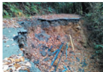
露出した水道管
