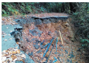
露出した水道管
