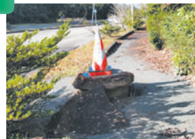
飛び出したマンホール
