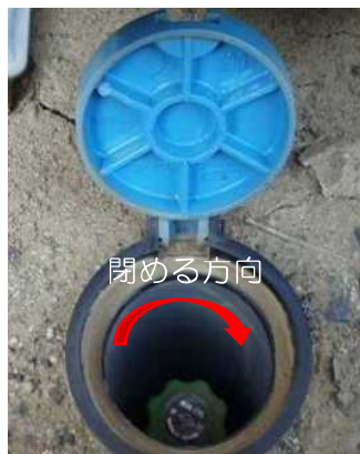
① 不凍栓（地下式）
