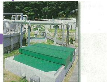
汚水流入管と汚泥ポンプ室
