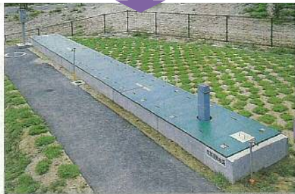
塩素接触水路
