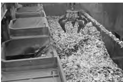
ごみピットとごみ投入口(ホッパ)
