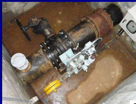
弁室内 緊急遮断弁
