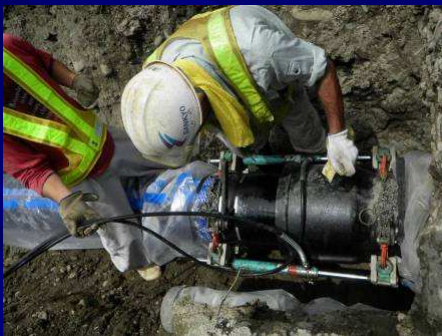
NS管継手状況
