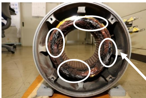
<電動機内部(固定子)>
