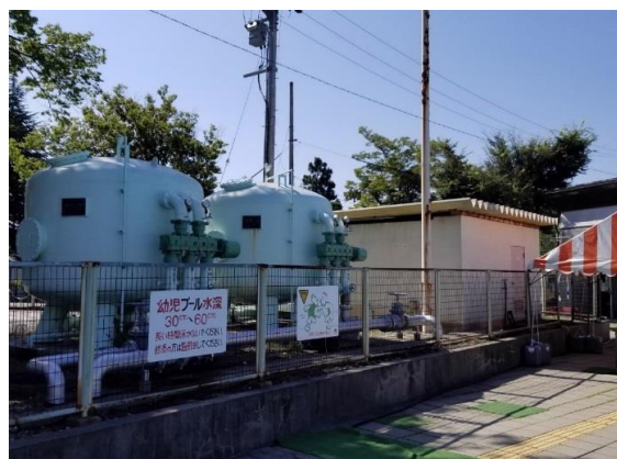
ろ過・給水設備
