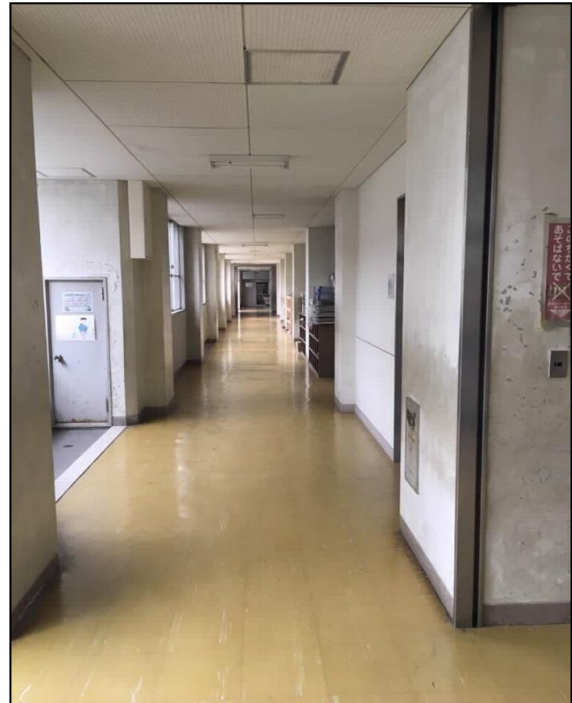
位置: 北校舎 廊下 撮影日: 平成30年6月11日
