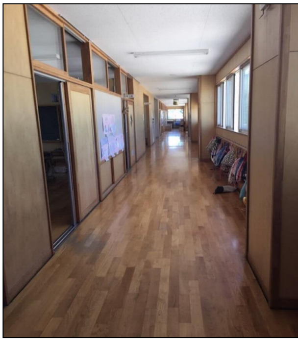
位置: 北校舎 廊下 撮影日: 平成30年6月7日
