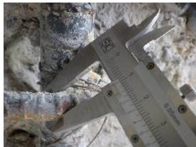
【鉄筋の腐食度】
