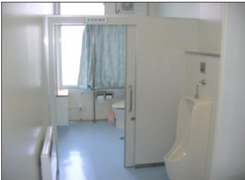
位置: 校舎1階男子トイレ 撮影日: 平成28年3月25日
