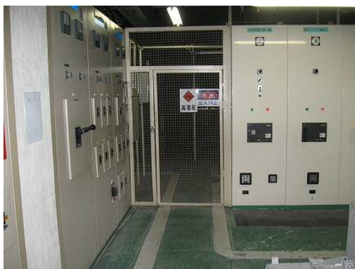
開放型電気室
