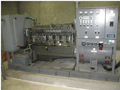
非常用発電機（屋内）
