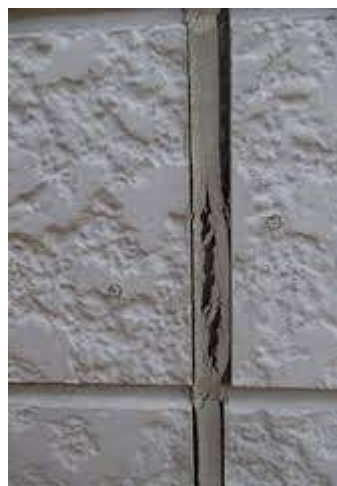
剥離、破断、ひび割れ
