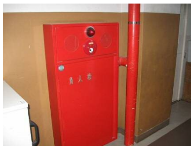
屋内消火栓箱
