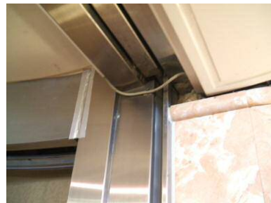
配線による閉鎖障害
