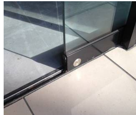
自動ドアレール
