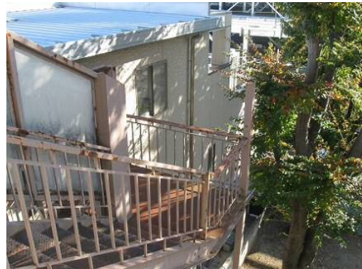
鉄骨階段の錆
