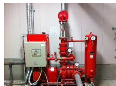
スプリンクラーポンプ
