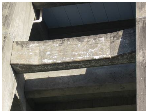
コンクリートのひび割れ
