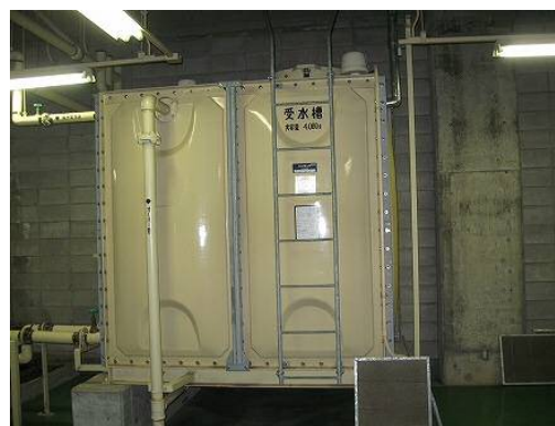
FRP 製受水槽 (屋内)
