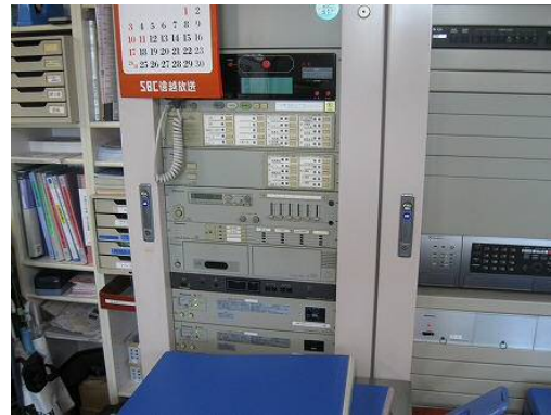
非常放送設備
