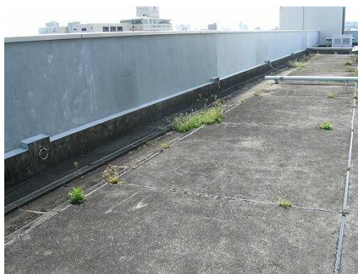
目地の劣化と雑草
