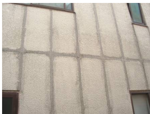
シーリングによる汚れ
