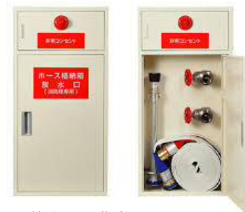
放水口、非常用コンセント
