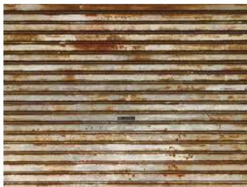
シャッターの錆
