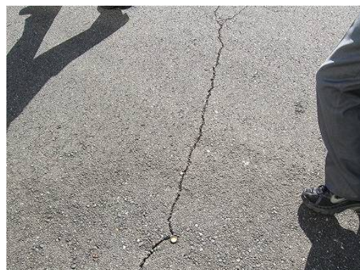
アスファルト舗装のひび割れ
