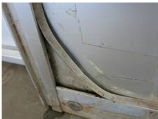
成型ゴム劣化
