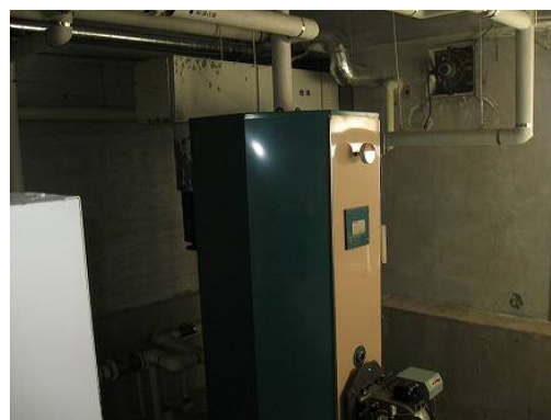
給湯ボイラー
