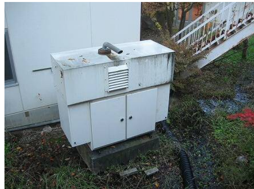
非常用発電機（屋外）
