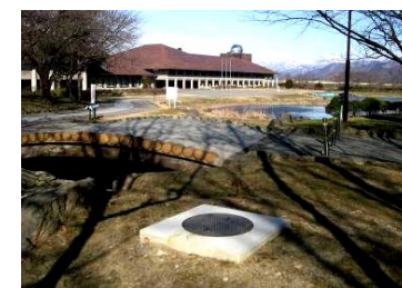
池送水ポンプ室(マンホール内)
