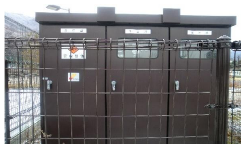
受電施設(管理外施設)
