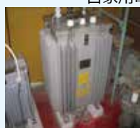
変圧器 (平成5年以前製造)
