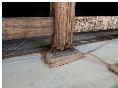
木部破損状況(宝殿)
