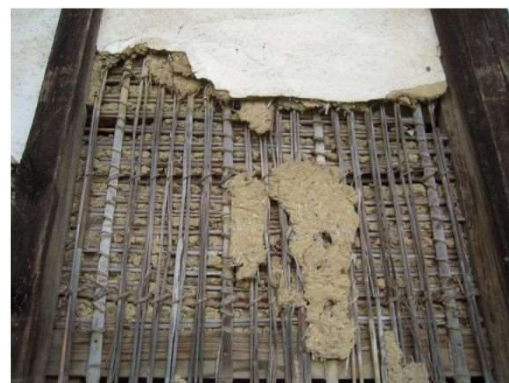
壁面破損状況・拡大(本堂/東面)
