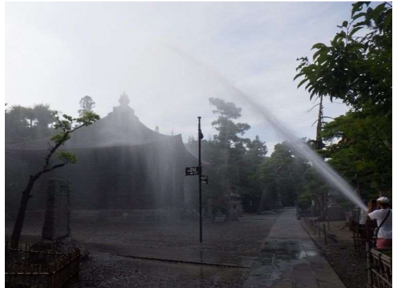
善光寺経蔵放水銃設備の放水試験
