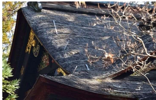
修理前屋根破損状況(宝殿/北西隅)
