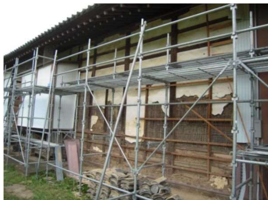
壁面破損状況(本堂/東面)
