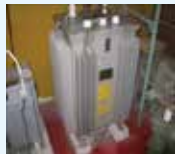
変圧器 (平成5年以前製造)
