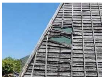
破損状況（拡大）
